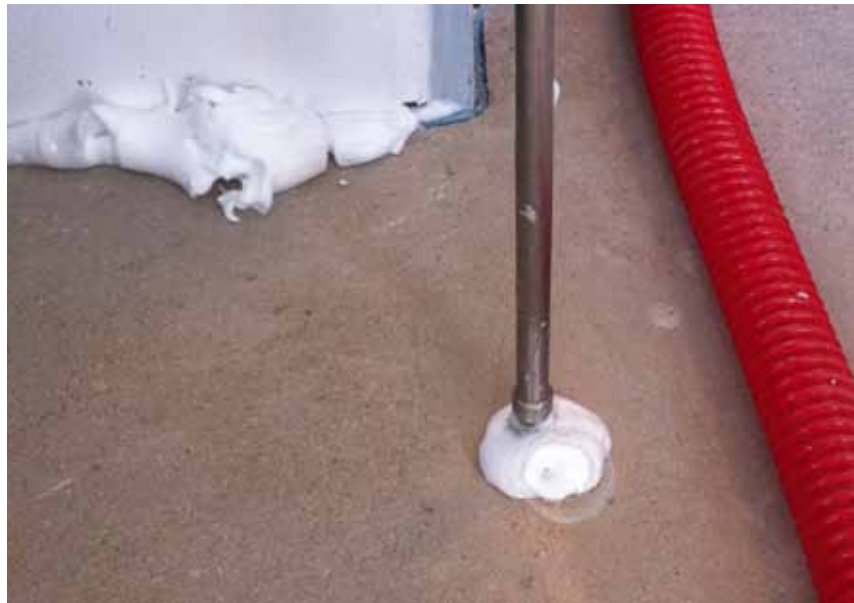
Abbildung: Injektion Trockenschaum zur Keimreduzierung im Bodenaufbau / schneller und kostengünstiger als Rückbau
